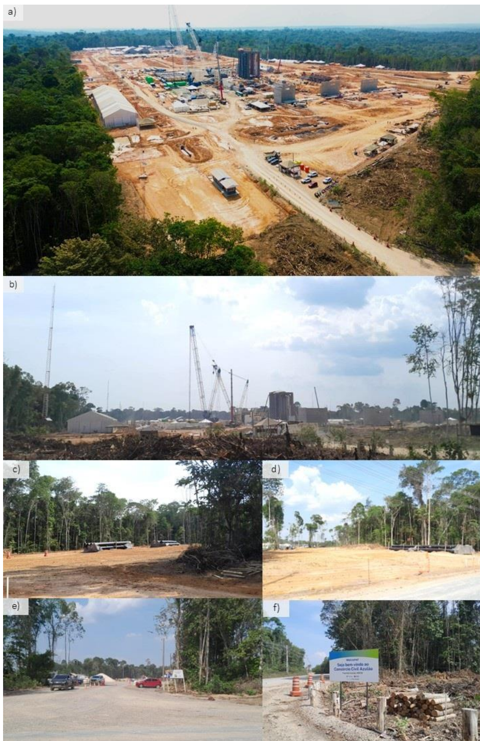
Figura 5. Obras no complexo do Azulão: a) visão geral do complexo; b) obras de construção; c) ramal de acesso; d) acesso para a construção de um aqueduto; e) entrada do canteiro de obras da subestação do complexo Azulão; f) rodovia e acesso ao complexo do Azulão. Fonte: figura A imagem cedida por Jonas da Silva Santos; demais imagens são do autor em outubro de 2024.
