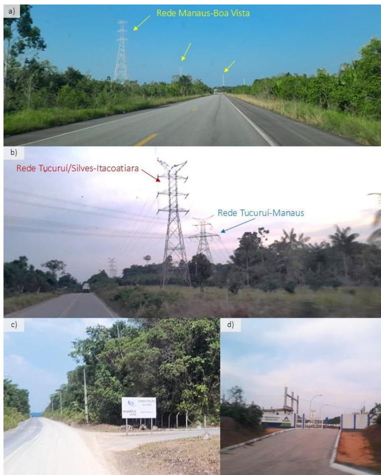
Figura 3. Infraestrutura de transmissão de eletricidade: a) rede Manaus-Boa Vista com as torres construídas no estado de Roraima; b) rede Tucuruí-Manaus e Tucuruí-Silves-Itacoatiara; c) e d) subestação ao longo da rodovia AM-363. Fonte: Imagens do autor no ano de 2024.
