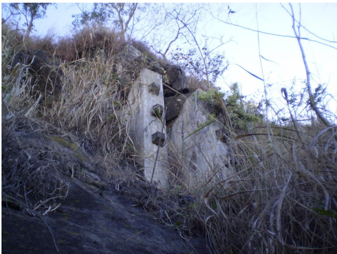
Fotografia 01 – Colunas de Contenção de Blocos na Vertente tombada do Morro do Cristo
