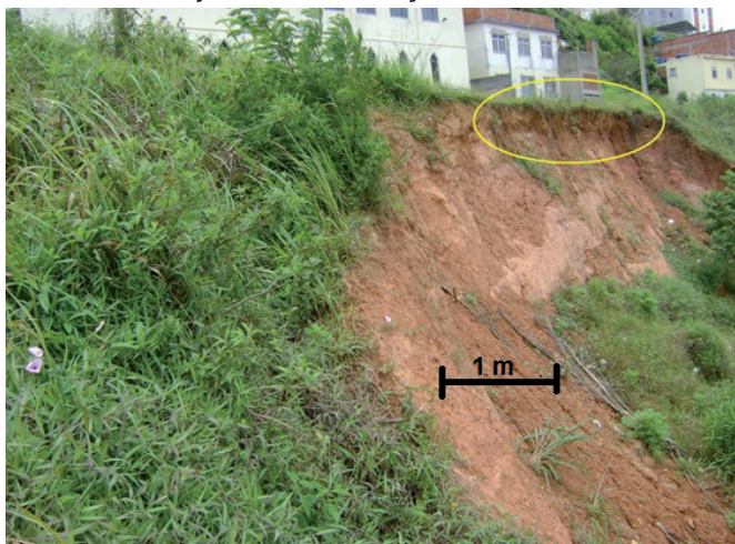
Foto 2: Erosão atuante na coroa do movimento (ver área circulado)
