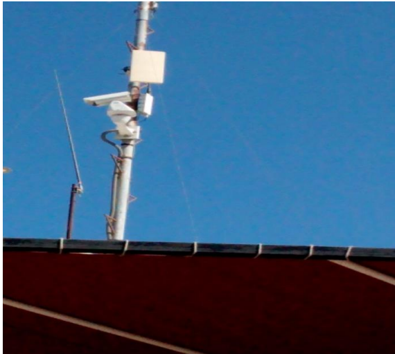
Fig. Cámara de vigilancia en Blvd. Lázaro Cárdenas y Paseo de La Marina.
