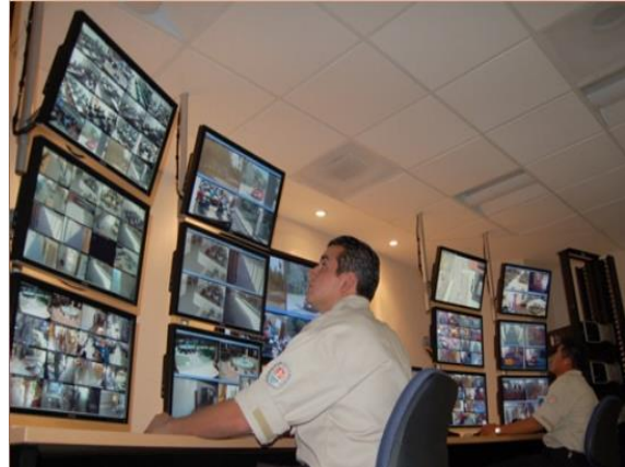
Fig. 4. Centro de Control y Monitoreo C2
