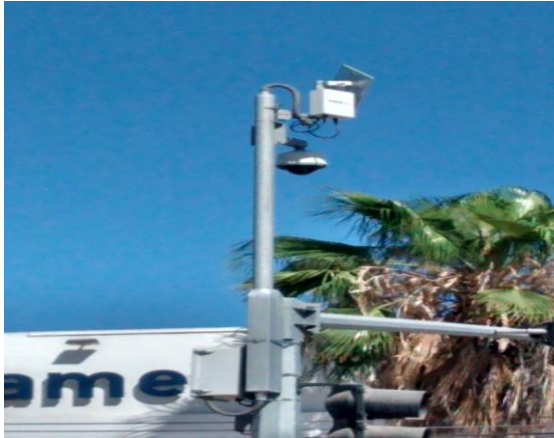
Fig. Cámara de vigilancia en Blvd. Lázaro Cárdenas y Paseo de La Marina.
